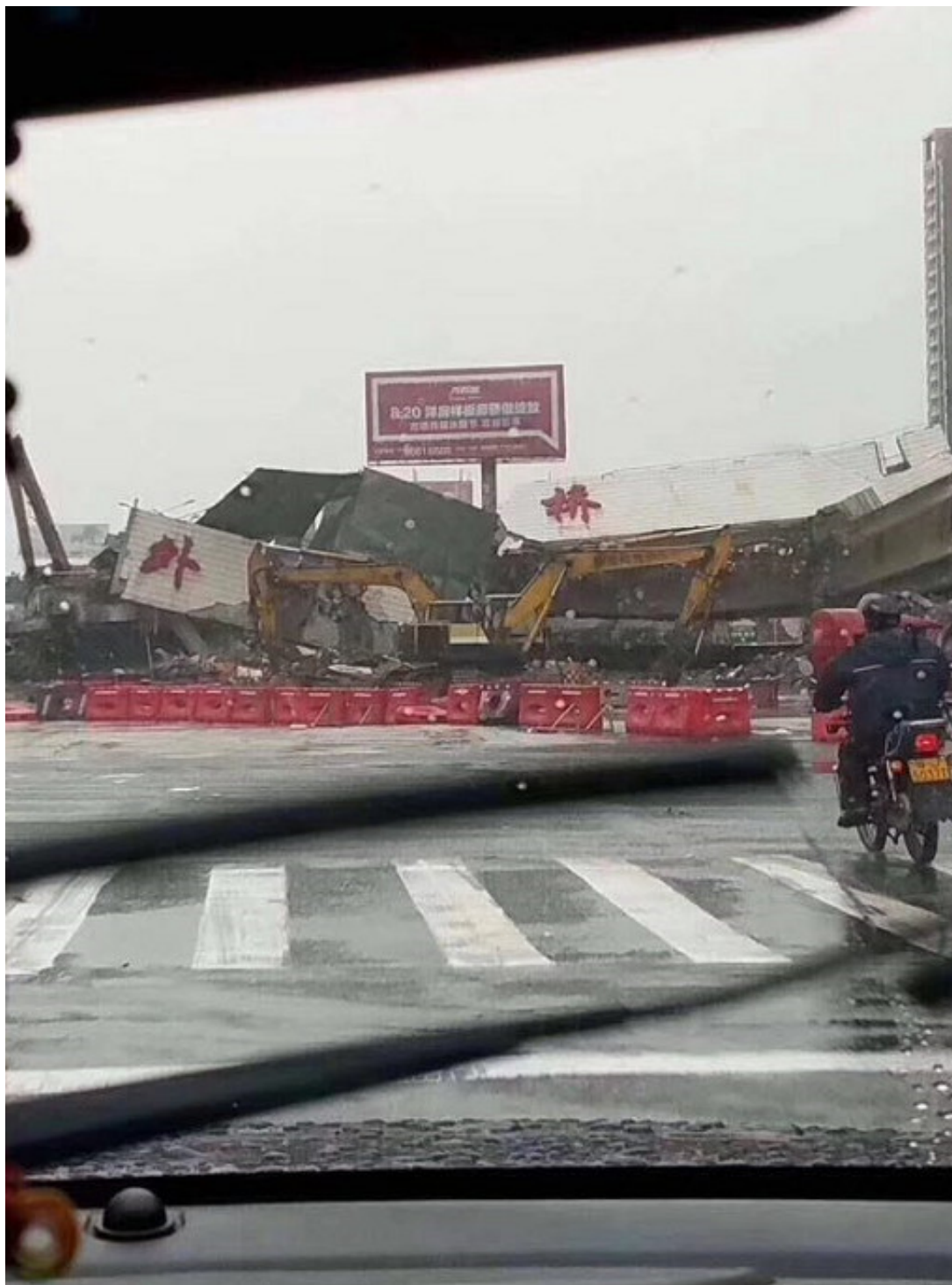
广东江门外海大桥倒塌？已经拆除，剩余结构是安全的
