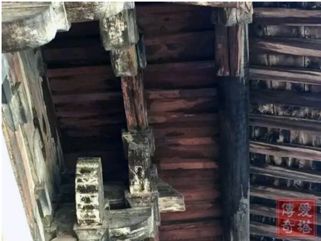
前沿下多处漏雨。图片来源：爱塔传奇公众号
