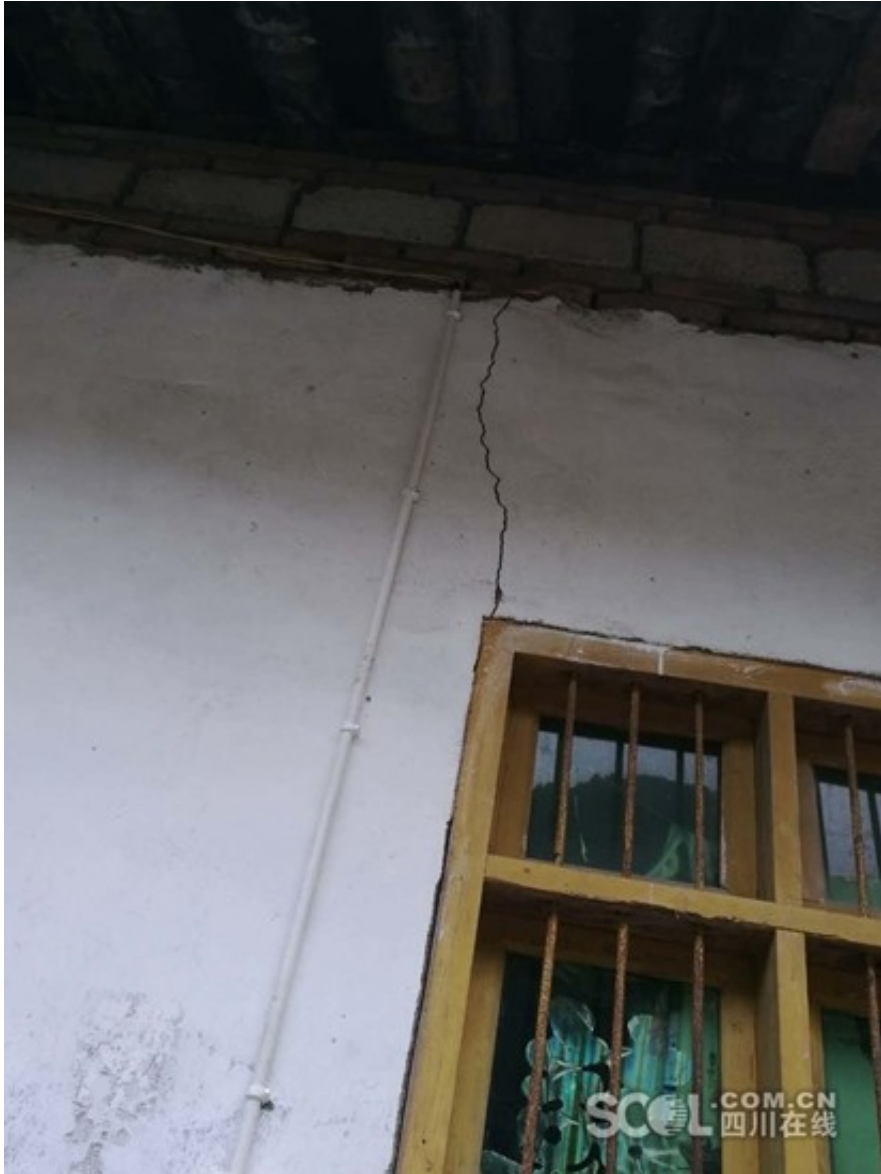
农房有轻微裂口。
