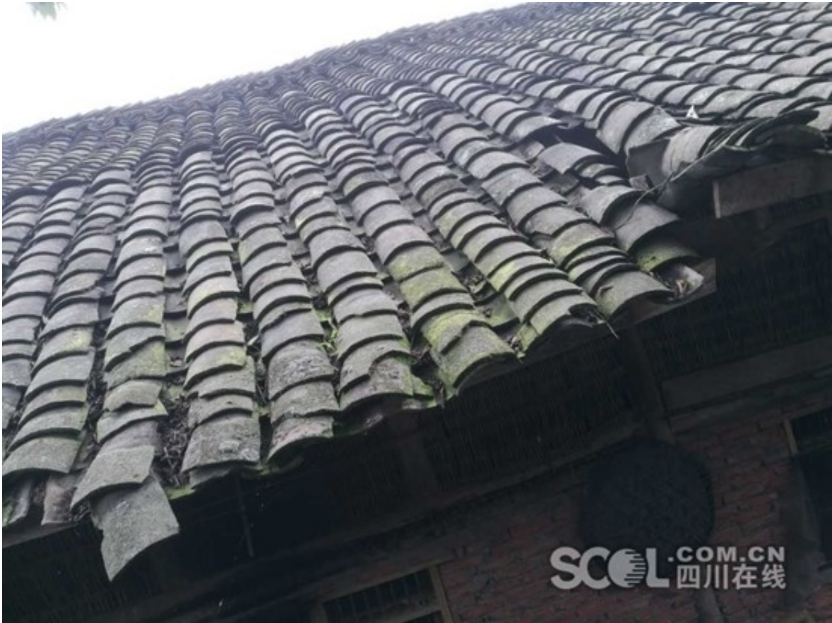
当地房屋瓦片掉落。
